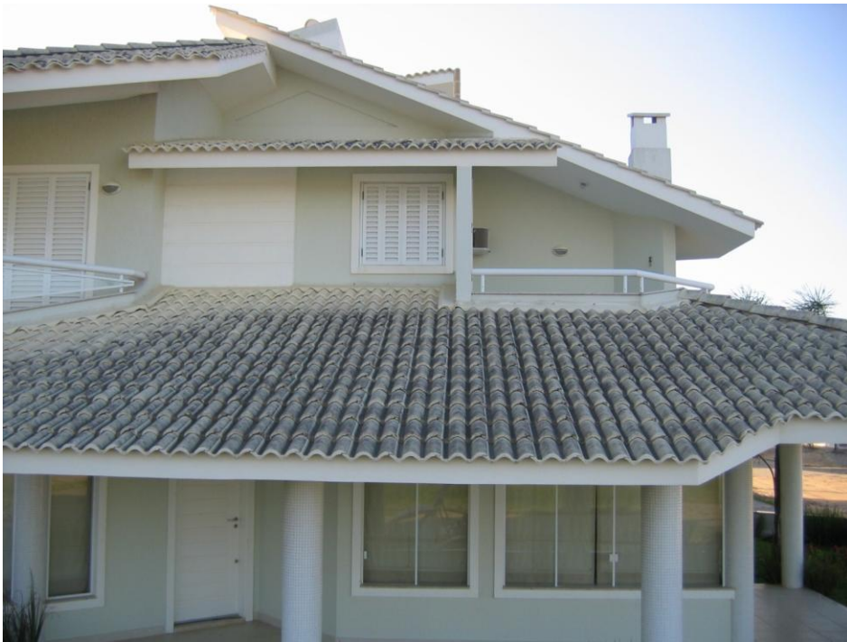
Telha de concreto sob ataque de fungos.
