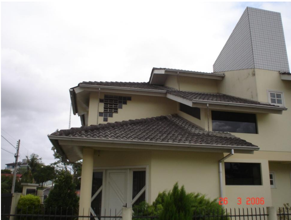
Telha de concreto sob ataque de fungos.
