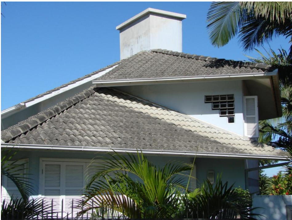
Telha de concreto sob ataque de fungos.
