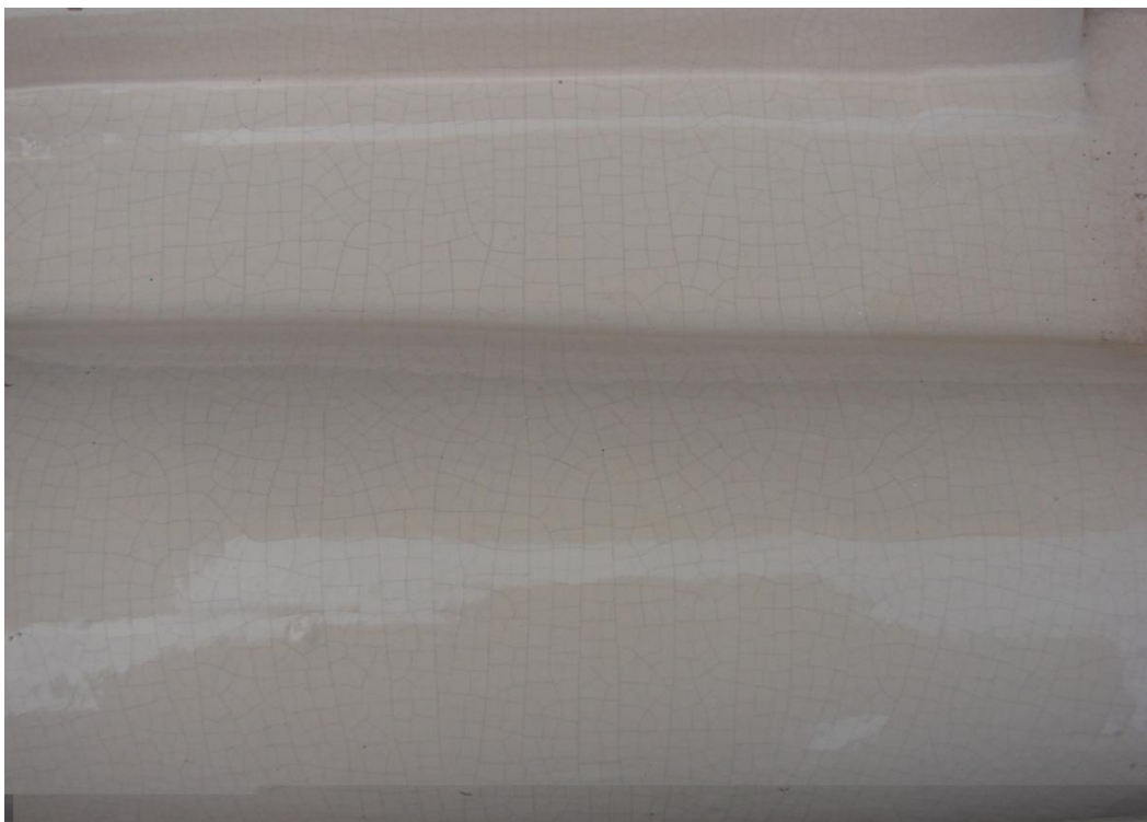
Telha de barro vitrificada com gretamento
