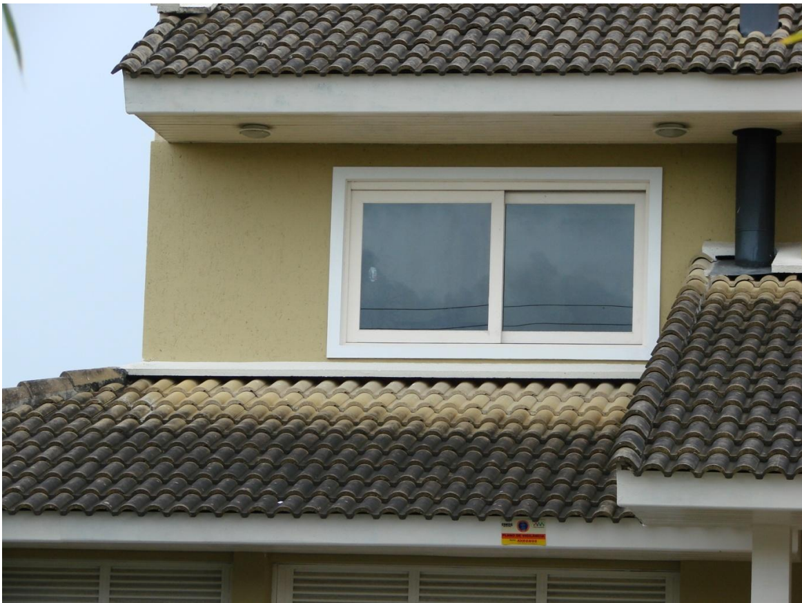
Telha de concreto sob ataque de fungos.
