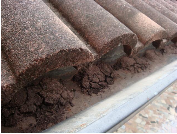
Telha de concreto em decomposição.
