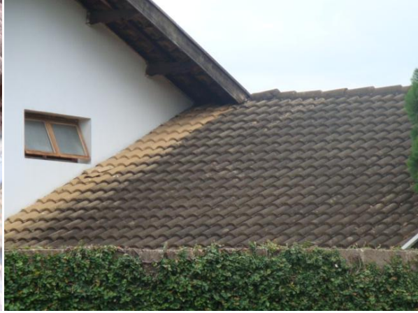
Telha de concreto com envelhecimento precoce
