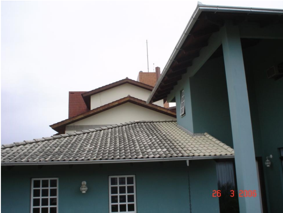
Telha de concreto sob ataque de fungos.
